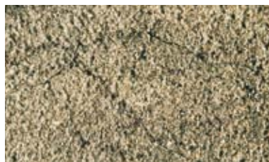
Stará omítka s prasklinami
